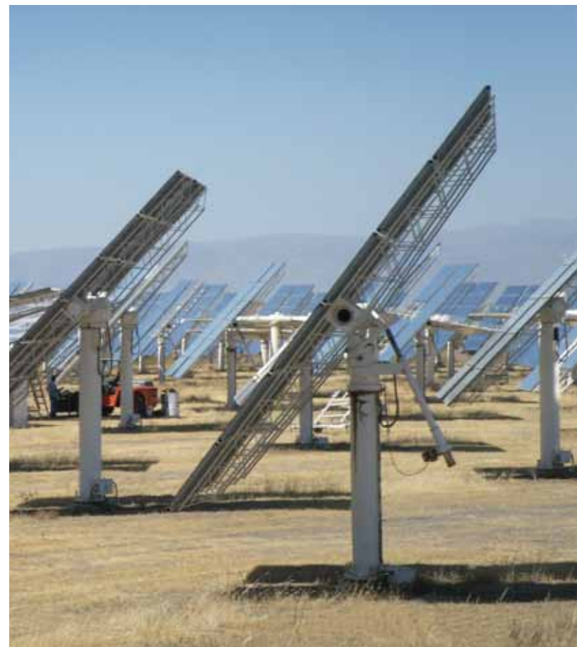
Planta de producción eléctrica con paneles solares fotovoltaicos
